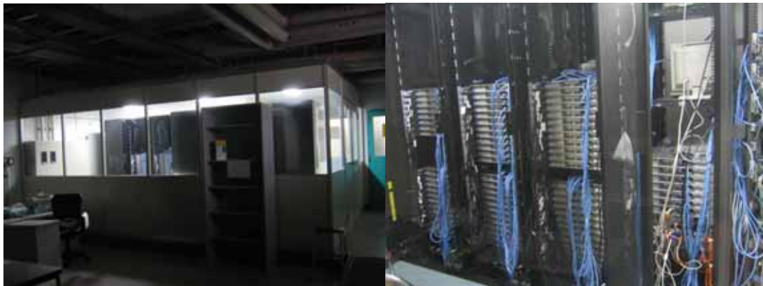
図 2 : 学術国際情報センター内に構築された COE「大規模知識資源の体系化と活用基盤構築」サーバの様子。完全な自動無人運転が可能(左)。左の三本のラックがフロントエンド計算ノード、右の一本が並列ファイルシステム、バックエンドの多重 RAID サーバノードなどを擁する。
