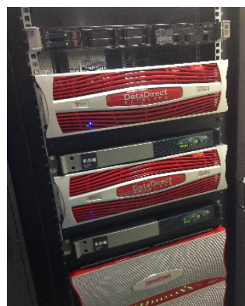
図 1 HPCI 共用ストレージ
