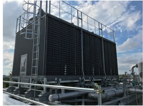
屋上に設置された冷却塔
